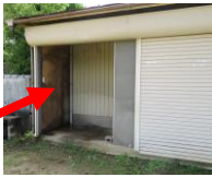
防災倉庫の雨漏りにより傷んだ壁面
